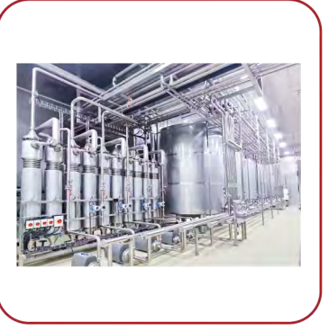
全自动CIP系统 Full automatic CIP system
